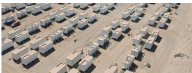
Batteriespeicher von Zelestra in Chile. Quelle: Zelestra
