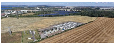
Batteriespeicher Leuna. Quelle: Münch Energie
