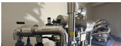
Wärmepumpe für das Glaswerk in Obernkirchen. Quelle: Ardagh Glass
