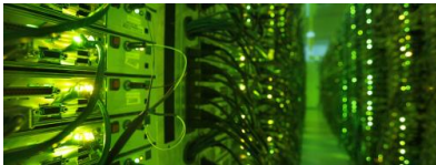
Blick in ein Rechenzentrum. Quelle: GMX
