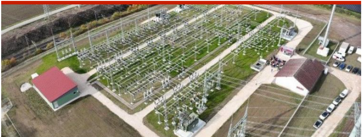
Umspannwerk. Quelle: N-Ergie
