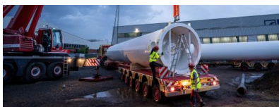
Anlieferung der Niederdruckspeicher im Stuttgarter Hafen. Quelle: Stadtwerke Stuttgart
