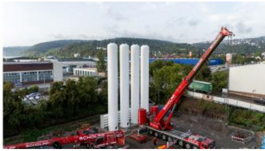
Vier weiße Niederdruckspeicher prägen ab sofort das Bild des künftigen Green Hydrogen Hubs im Stuttgarter Hafen Quelle: Stadtwerke Stuttgart
