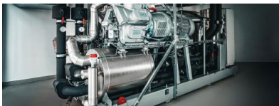
Die Meerwasser-Wärmepumpe hat ihre Arbeit in Neustadt aufgenommen. Quelle: Johnson Controls
