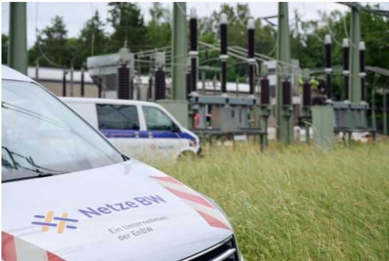
Anfang Juni war ein Umspannwerk in Reutlingen (Baden-Württemberg) bei einem Brandanschlag schwer beschädigt worden. Quelle: Netze BW
