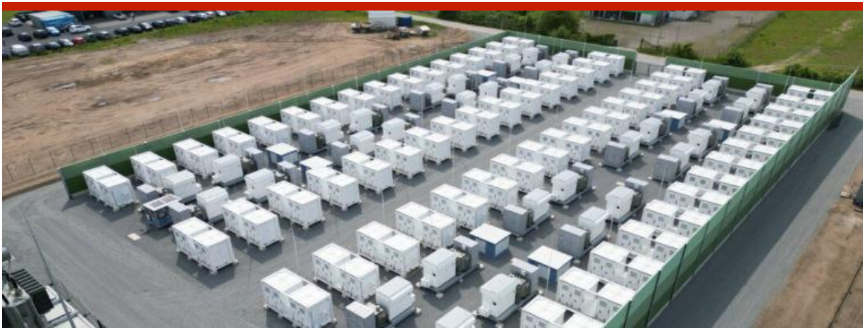
Großbatteriespeicher Bollingstedt in Schleswig-Holstein. Quelle: Ecoster
