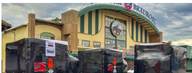
Noch verpackt: die Batteriespeicher nach der Ankunft auf der Wies'n. Quelle: Tesvolt
