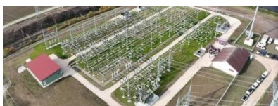
Umspannwerke und andere Energieanlagen haben es zunehmend mit Drohnenaktivitäten zu tun. Quelle: N-Ergie
