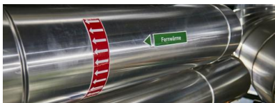
Hansewerk Natur kümmert sich in Zukunft um die Nahwärme in Tarp. Quelle: Hansewerk
