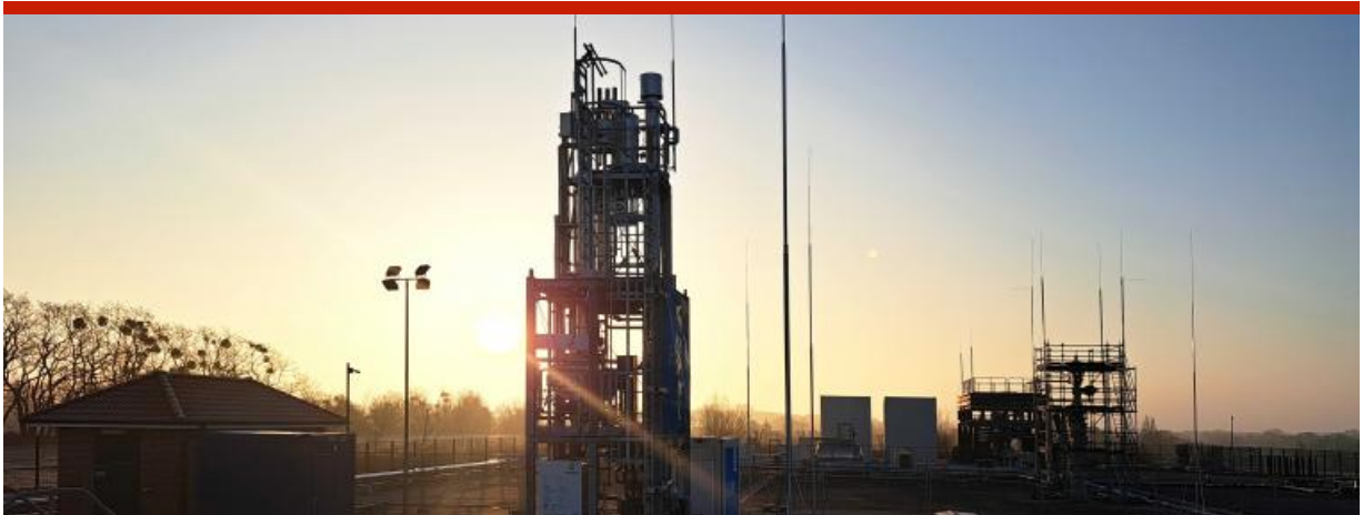
Kleinere von Bilfinger entwickelte H2Dry-Testanlage. In Huntorf soll die Technologie im kommerziellen Maßstab zum Einsatz kommen. Quelle: Bilfinger
