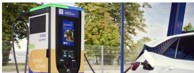
Eine zweistellige Zahl von 480-kW-Ladesäulen will EnBW bis Ende des Jahres errichten. Quelle: EnBW
