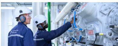
Die Stadtwerke Münster haben ihre zweite Großwärmepumpe in Betrieb genommen. Quelle: Stadtwerke Münster / Michael C. Möller
