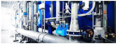
Großwärmepumpen sind ein Schlüssel zur Dekarbonisierung der Fernwärme. Quelle: Fraunhofer IEE
