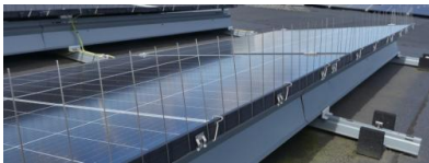
Edelstahlpins an den Modulrändern sollen verhindern, dass es sich Vögel auf den PV-Anlagen gemütlich machen. Quelle: RoofTech GmbH
