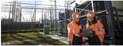
Techniker während eines Kontrollrundgangs in einem Umspannwerk. Quelle: 50 Hertz
