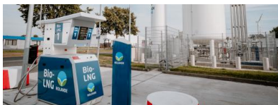
Der Standort der neuen Bio-LNG-Tankstelle liegt in unmittelbarer Nähe zur deutsch-niederländischen Grenze. Quelle: Rolande
