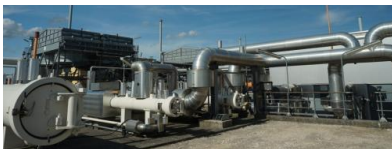
Oberirdische Gasspeicheranlagen. Quelle: Davina Spohn
