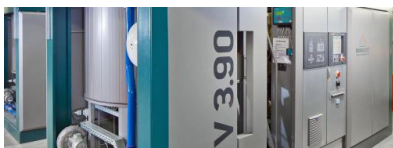
Zwei nebeneinander aufgestellte Holzvergaser mit dem runden Reaktor der vorderen Anlage auf der linken Seite. Quelle: Burkhardt
